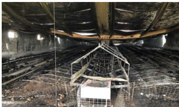
DAÑOS POR INCENDIO EN EXPLOTACIÓN AVÍCOLA
