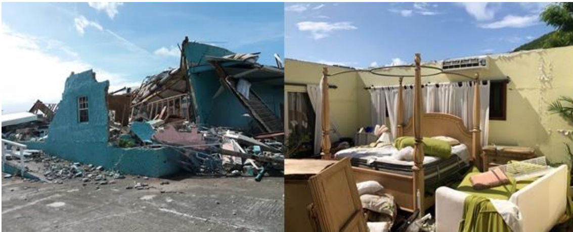
Viviendas totalmente inhabitables tras los fuertes vientos asociados a Irma y María.
