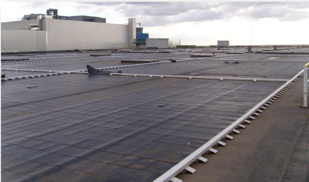
Vista en planta de la instalación fotovoltaica sobre una de las cubiertas
