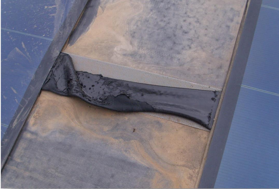
Obsérvese el estado del velcro tras el desprendimiento de un panel
