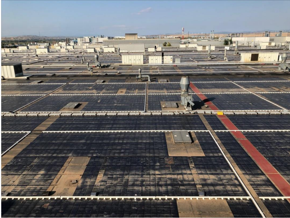
Vista de la instalación fotovoltaica sobre una de las cubiertas de la factoría
